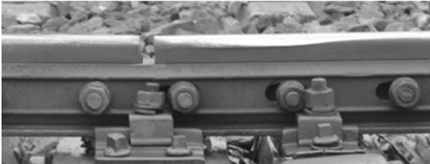
Rys. 7. Przykład wadliwego połączenia szyn i uszkodzeń toru jako rezultat tej wady
