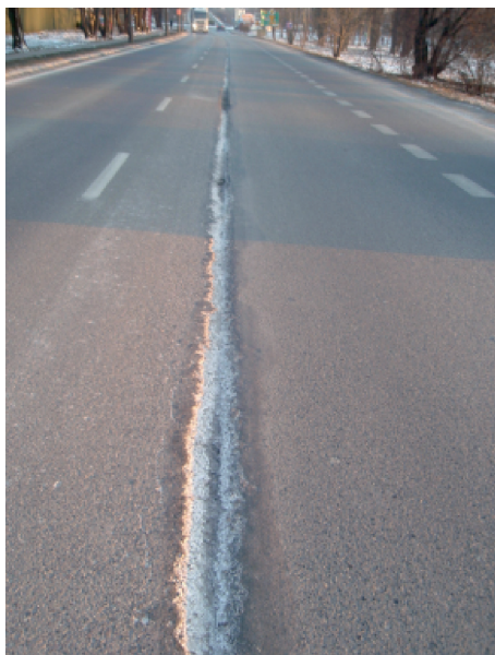
Fot. 8. Wygląd (po czwartej zimie) skutku nieszczelności w miejscu złącza podłużnego na jednej z dróg wojewódzkich (po drugiej zimie rozszczelnienie „uszczelniono” stosując powierzchniowe utwardzenie). Po dwóch latach nie widać nawet śladów powierzchniowego utwardzenia [1]
