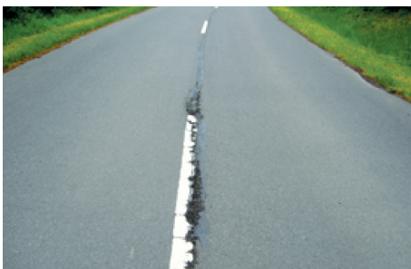
Fot. 10. Widok nieszczelnego złącza podłużnego [2]
