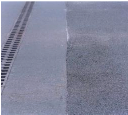
Fot. 4. Nieszczelne spoiny technologiczne między nawierzchnią asfaltową i betonową oraz nawierzchnią betonową i obudową liniowej kratki ściekowej [1]
