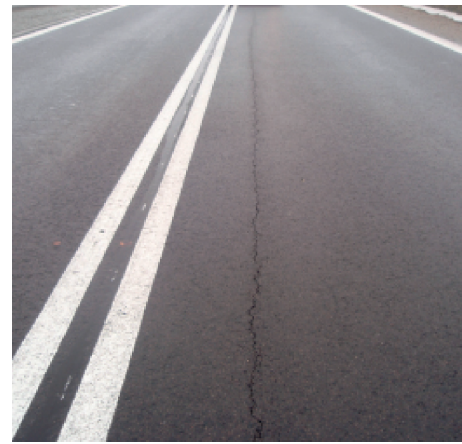
Fot. 6. Przykład pęknięcia podłużnego nawierzchni asfaltowej [1]
