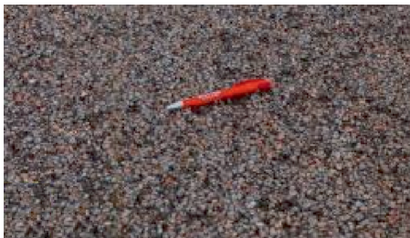
Fot. 14. Widok nawierzchni asfaltowej w początkowej fazie przyspieszonej degradacji: nieszczelność, widoczne pierwsze wykruszenia ziaren kruszywa [2]
