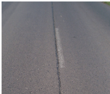
Fot. 2. Nieszczelne złącze podłużne [1]
