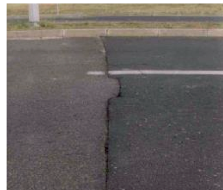
Fot. 3. Nieszczelna spoina poprzeczna [1]
