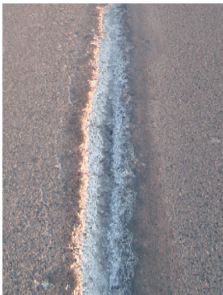
Fot. 9. Zbliżenie wyglądu skutku nieszczelności pokazanego na fot. nr 8. Głębokość ubytku nawierzchni sięga całej grubości warstwy ścieralnej, szerokość ubytku waha się w granicach 4–12 cm. Biały kolor powstał wskutek działania roztworu soli używanej do odladzania nawierzchni [1]
