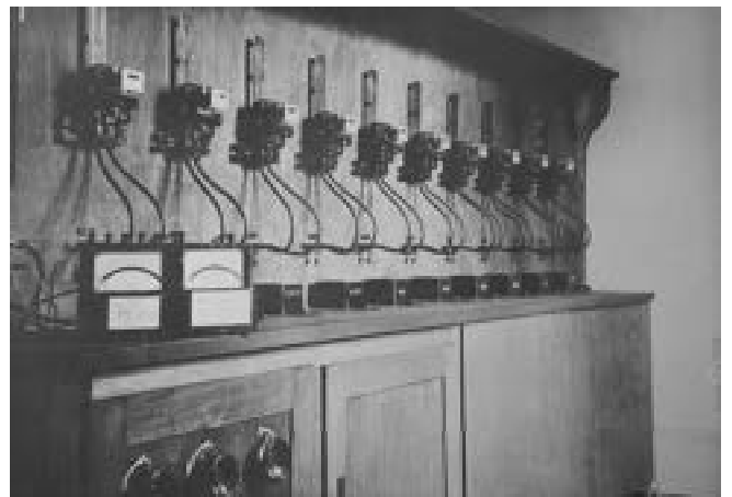
Rys. 7. Licznikownia Elektrowni Miejskiej w Rzeszowie. Stanowisko do legalizacji liczników, 1932 rok
