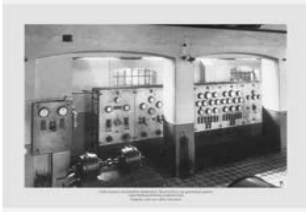
Rys. 4. Hala maszyn rzeszowskiej elektrowni. Rozdzielnica i przetwornica
