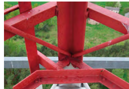
Rys. 5. Wada spoiny z uwagi na brak pełnego przetopu
