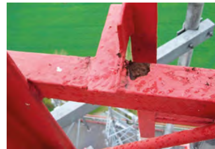
Rys. 4. Korozja wgłębna spowodowała odprysk farby
