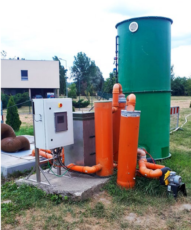
Instalacja testowa dezodoryzacji z wykorzystaniem różnych materiałów sorpcyjnych
