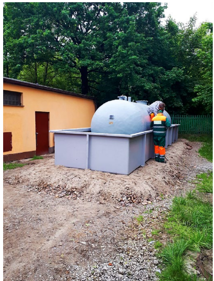
Zbiornik z instalacją dezodoryzacji chemicznej przy ul. Portowej
