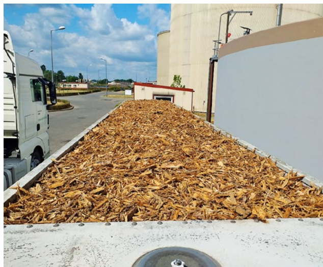
Biofiltr przy budynku zagęszczania i odwadniania ze złożem wymienionym w 2019 r.
