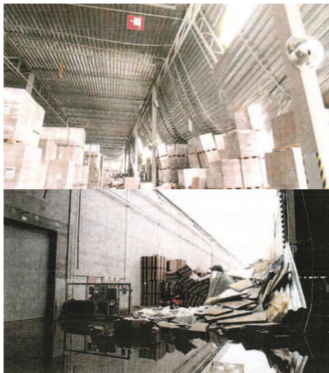
Rys. 1. Zawalony dach obiektu magazynowego
