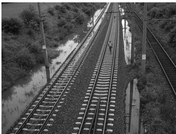
Rys. 4. Podtopienie podtorza z powodu niewłaściwego odwodnienia [mat. autorów]
