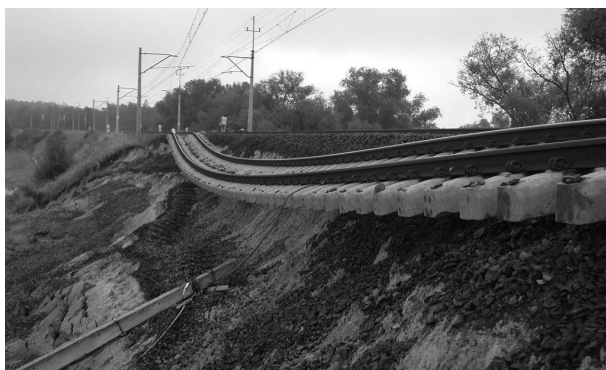
Rys. 2. Osuwisko nasypu kolejowego obejmujące zasięgiem jeden tor [mat. autorów]
