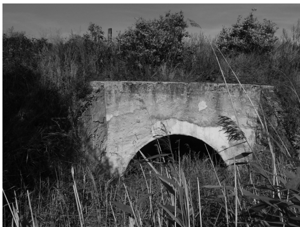
Rys. 3. Niedrożny przepust [mat. autorów]
