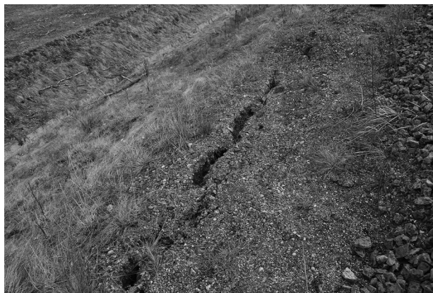
Rys. 5. Pęknięcie nasypu na ławie torowiska [mat. autorów]
