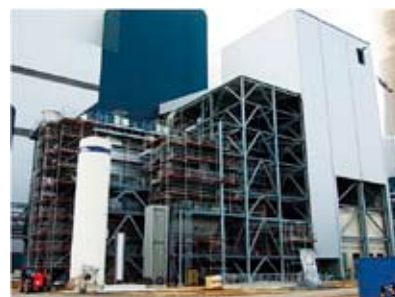
Instalacja pilotażowej suszarni fluidalnej w elektrowni Nideraussem
