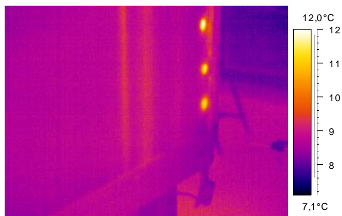
Rys. 10. Skutek ciepły niefachowej naprawy rozerwanego poszycia zewnętrznego
