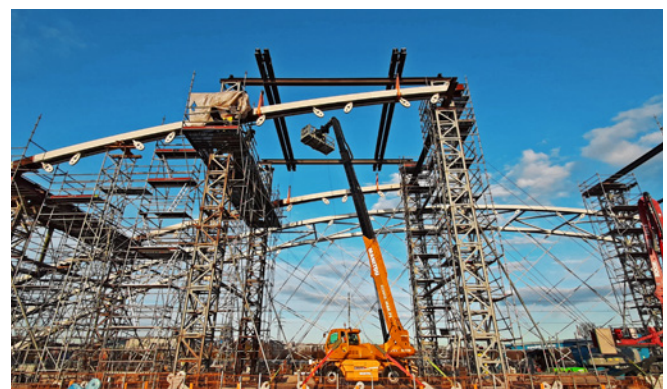
Ryc. 17. Element łuku konstrukcji stalowej zamontowany przy użyciu cięgien sprężających, fot. W. Ostrzolek
