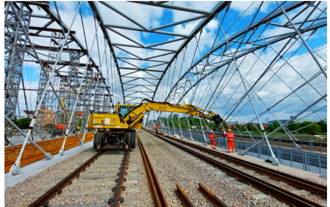
Ryc. 20. Kontrola sił w wieszakach, fot. W. Ostrzołek
