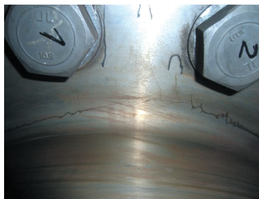
Rys. 3. Pęknięcia po obwodzie oraz pęknięcia promieniowe [1]
