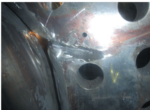
Rys. 5. Przebieg naprawy. Przygotowanie rowka spawalniczego z uwagi na grubość kołnierza i wielkość pęknięcia [1]
