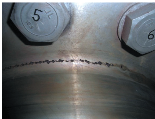
Rys. 2. Pęknięcia po obwodzie z wykruszeniem [1]
