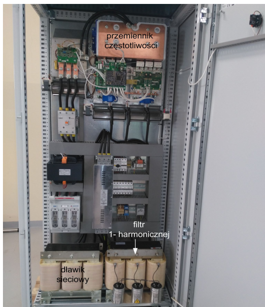
Rys. 9. Zdjęcie szafy źródła napięcia systemu stacji prób silników prądu stałego
