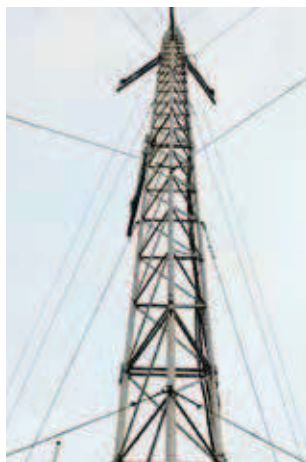
Rys. 5. Maszt o trzonie aluminiowym kratowym o wysokości 16 m; błędne napięcia lin i układu odciągów powodujących skrętną pulsację masztu przy działaniu wiatru (fot. archiwum autora)
