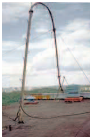
Rys. 7. Przykład masztu o trzonie rurowym stalowym wysokości 29,5 m i linach stalowych \varnothing=10 mm; brak wypadku z ludźmi; straty na materiale; zdarzenie – lipiec 1993 r. (fot. archiwum autora)
