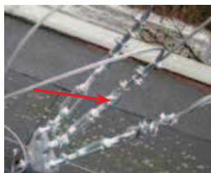
Rys. 10. Widok przesunięcia pętli odciągów linowych \varnothing = 8 mm na maszcie antenowym 16,5 m na odciagu środkowym poza kauszę o 30 mm; widać błędne założenie zacisków (na przemian) (fot. archiwum autora)
