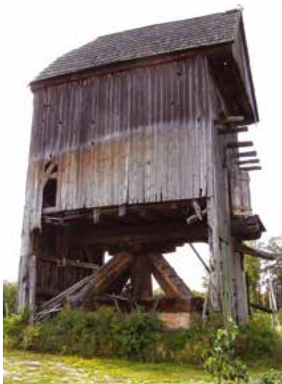
Fot. 1. Wiatrak koźlak w m. Linin, gm. Góra Kalwaria, widok ogólny obiektu przed remontem; źródło: fot. F. Tomaszewski, wrzesień 2021 r.
