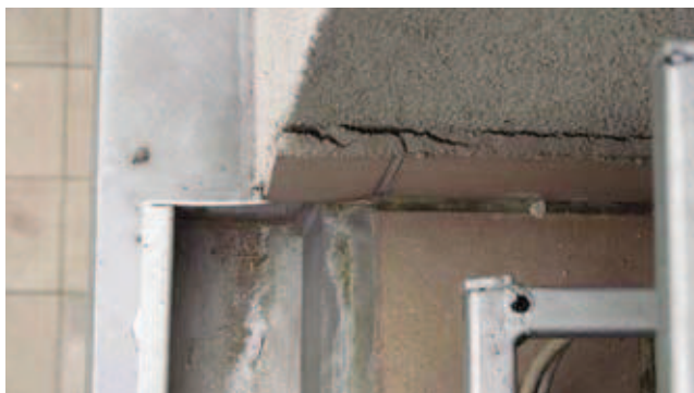
Rys. 3. Odspojony cokół przy murku balustrady tarasowej
