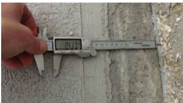
Rys. 5. Zbyt nisko wyprowadzone taśmy uszczelniające na elementy pionowe budynku
