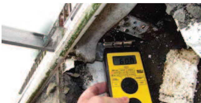
Rys. 8. Odkrywka przy krawędzi tarasu. Woda na poziomie paroizolacji, skorodowane elementy metalowe, zawilgoceny krawężniak drewniany
