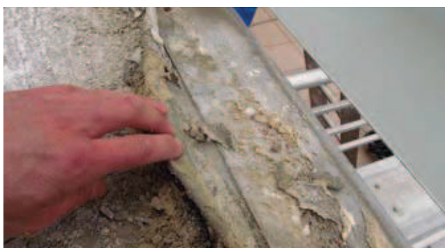
Rys. 4. Odspojona izolacja szlamowa (taśma) od obróbki blacharskiej
