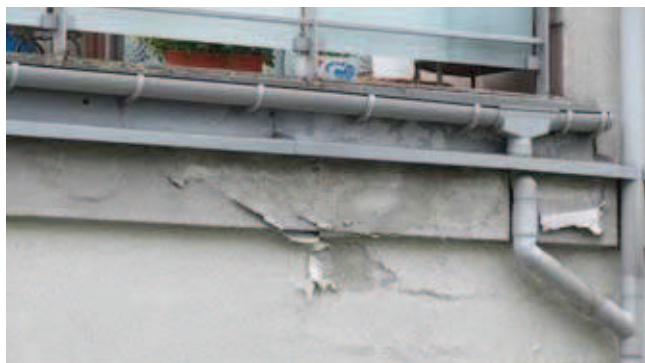
Rys. 10. Zalania elewacji w wyniku wad izolacji tarasowych
