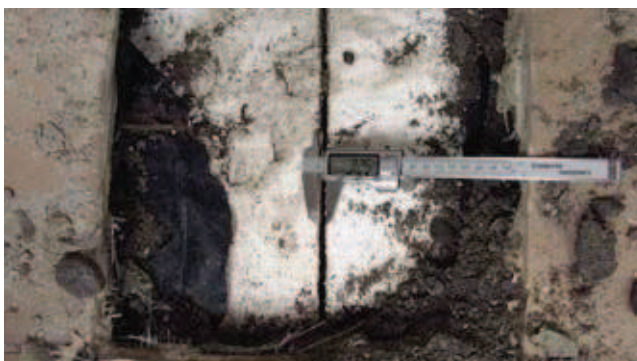
Rys. 7. Płyty styropianu EPS o jednolitej grubości 10 cm ułożone w sposób nie gwarantujący szczelności izolacji termicznej
