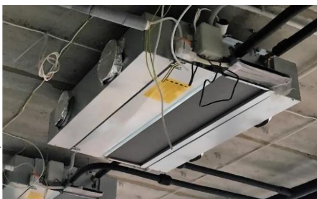
Rys. 8. Wentylokonwektor w systemie dwururowym
