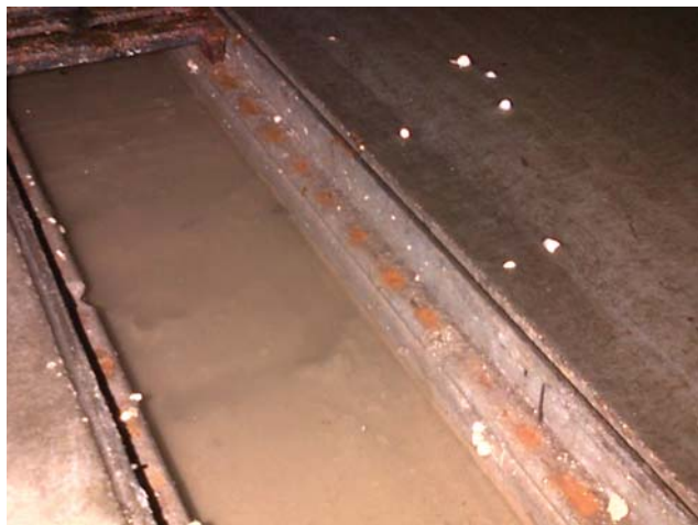
Fot. 2. Widoczne zwierciadło wody w odkrytej kratce ACO na poziomie „-2”
