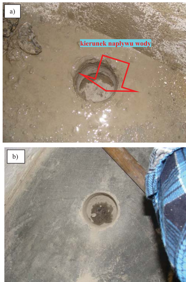
Fot. 3. Widok wykonanych miejscowych odkrywek, a) odkrywka na poziomie „-2” (widoczny na fot. b) przeciek wody od strony połączenia ściany szczelinowej z płytą denną – wada wykonawcza ), b) poziom „-1” – zaciekająca woda spod posadzki – oznacza to nieskuteczność powierzchniowego odprowadzenia wód oraz nieszczelności na dylatacjach posadzki – wada wykonawcza
