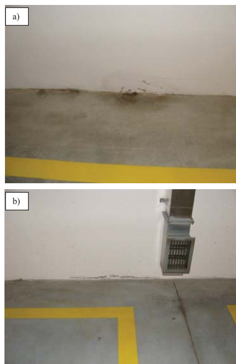
Fot. 1 a, b) Przykłady występującego zawilgocenia ścian wewnątrz garażu podziemnego
