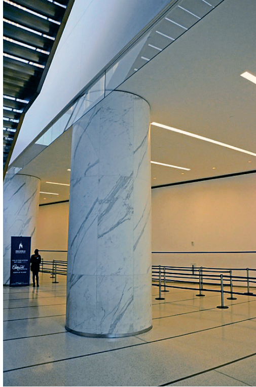
Rys. 10. Żelbetowy słup nośny w zewnętrznej części budynku na poziomie pierwszej kondygnacji poniżej lobby, fot. wykonana przez autorów
