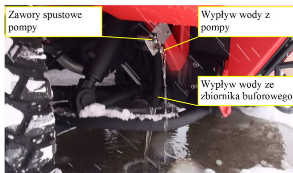
Rys. 9 Odwodnienie pompy pożarniczej
