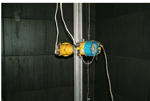
Rys. 5. Widok ogólny czujników stężeń tlenu, tlenku i dwutlenku węgla zamontowanych na słupkach [28]
