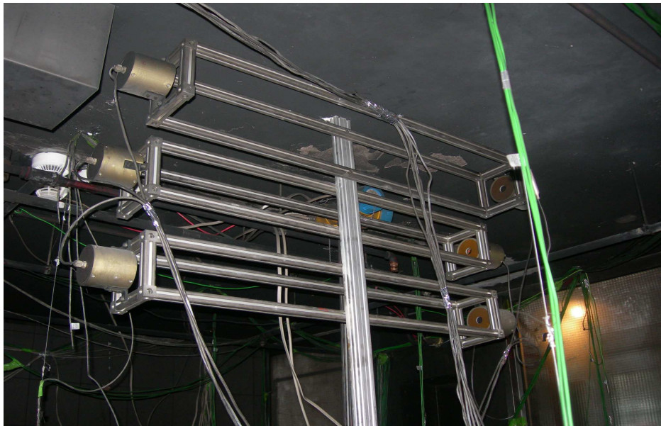
Rys. 8. Widok ogólny czujników gęstości dymu zamontowanych na ruchomym stelażu [28]
