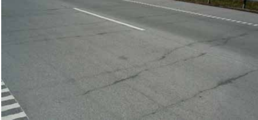
Rys. 1. Nieregularne rysy termiczne powstałe na nawierzchni betonowej pozbawionej dylatacji [7]
