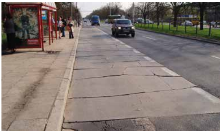
Rys. 4. Nawierzchnia betonowa zniszczona wskutek mechanizmu pompowania
