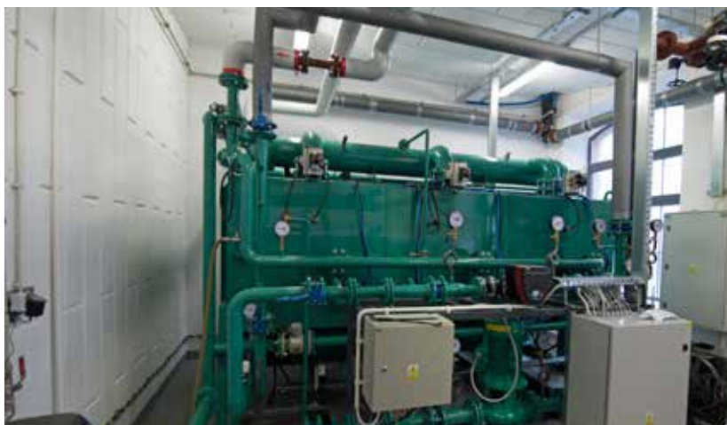
Agregat 50 kW, fot. EC Zielona Góra
