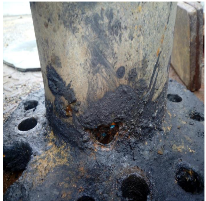
Rys. 5. Uszkodzenie króćca ssawnego
