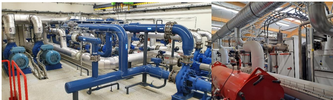
Fot. 8–9. Wizyty w geotermalnych instalacjach ciepłowniczych na Islandii: { stacji pomp w Reykjavíku (po lewej), instalacji ORC (po prawej) (fot. B. Kępińska)
