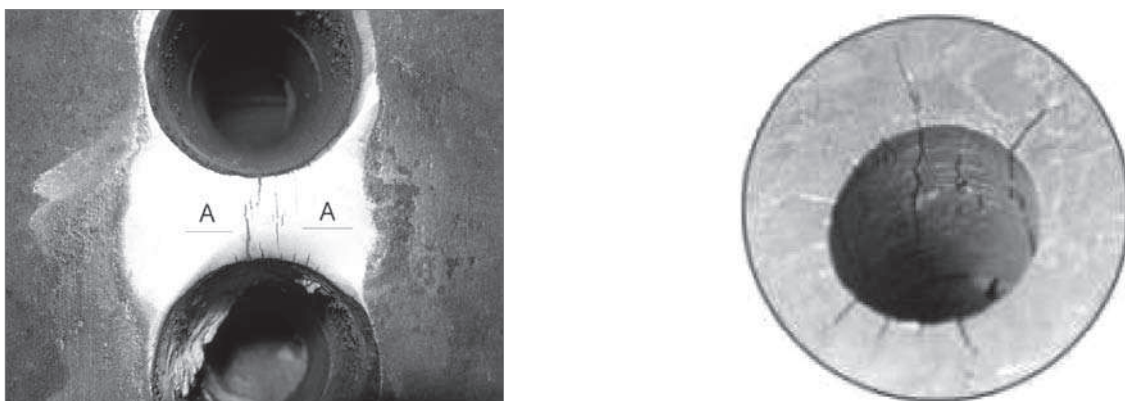
Rys. 2. Pęknięcia w obszarze międzyotworowym płaszczka komory wylotowej przegrzewacza pary pierwotnej ze stali X20CrMoV11-1 po długotrwałej eksploatacji w warunkach pełzania wywołane udarem cieplnym [6-9]
