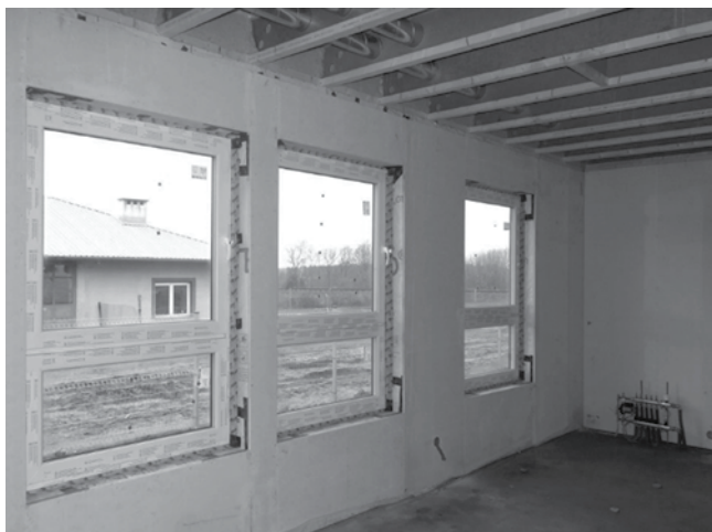
Rys. 5. Widok na pomieszczenie wewnątrz obiektu budowanego w systemie STEICO – widoczna niezamknięta jeszcze konstrukcja stropu. Obiekt – szkoła w Czarnej Wodzie. View of the room inside the building constructed in the STEICO system – the ceiling structure is still open. The facility - a school in Czarna Woda. Źródło: [5]
