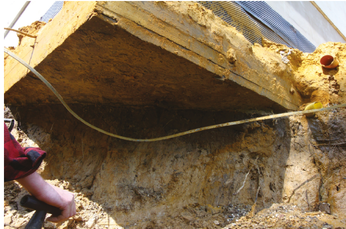
Fot. 3. Nisza osuwiskowa pod ławą fundamentową Fot. 3. Landslide scar under continuous footing
