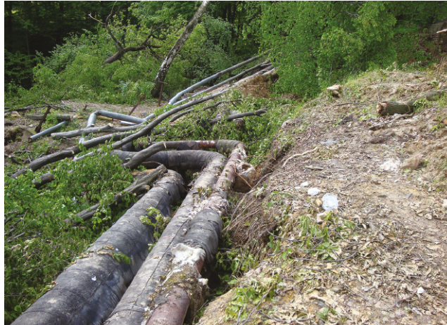
Fot. 8. Zniszczony odcinek napowietrznego rurociągu ciepłowniczego Rn 250
