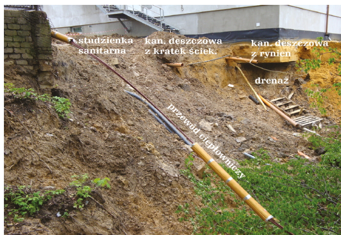
Fot. 2. Nisza osuwiskowa ze zniszczoną infrastrukturą podziemną
