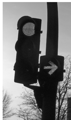
Fot. 2. Madryt – sygnalizator z dodatkową komorą nadający sygnał czerwony oraz zielony w kształcie strzałki
