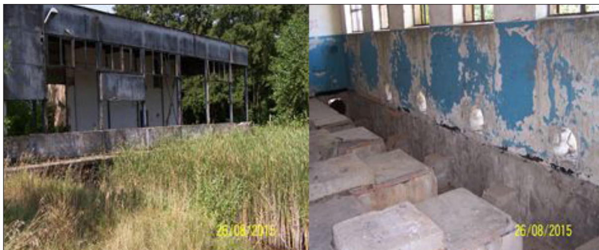
Fot. 1. Zdevastowane budynki przepompowni w Niepruszewie i Jeziorkach w 2015 roku Fot. 1. Devastated buildings pumping stations in Niepruszewo and Jeziorkach in 2015
