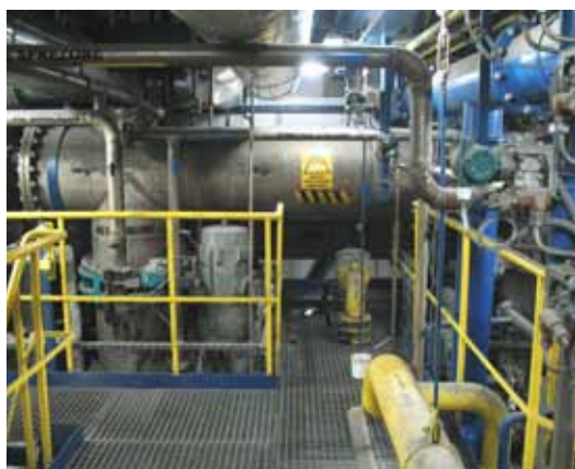
Rys...12. Fragment instalacji końcowej – pomost obsługowy palników głównych [1].
