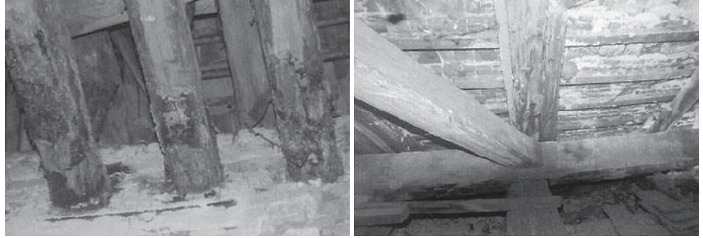
Rys. 17. Elementy więźby dachowej porażone przez zarodniki grzyba domowego i niszczone przez owady, źródło: badanie mykologiczne z roku 2013 [8]
