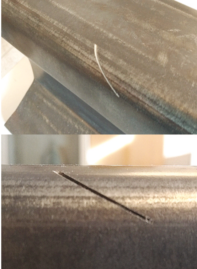
Rys. 7. Zobrazowanie wady nr 2223 - Head Checking. W górnym oknie obraz pęknięć na łuku toru, dolne okno widoczne pęknięcia na odcinku prostym.
