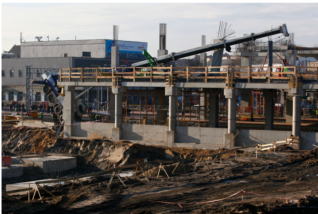
Rys. 7. Zdjęcie przedstawiające przewróconego żurawia oraz uszkodzenia konstrukcji Źródło: [3] fotograf: Adam Górczewski
