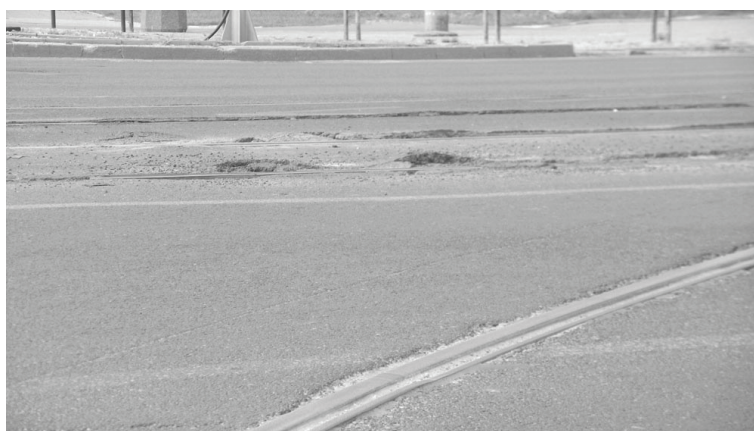
Fot. 5. Wypiętrzenia nawierzchni na przejeździe nr 19 Hucisko – 3 Maja
