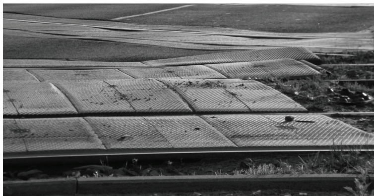
Fot. 2. Deformacje płyt na przejazdach nr 2 i 3 Okopowa – al. Armii Krajowej
