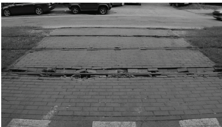
Fot. 6. Zapadnięcia kostki na przejeździe nr 54 Nowotna – Wyjazd z lasu nr 5
