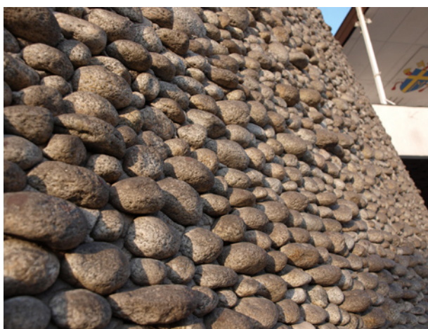
Ryc. 8. Kościół Matki Bożej Królowej Polski w Nowej Hucie – faktura ścian; fot. autor
