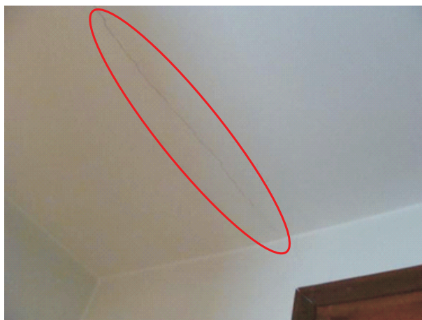
Rys. 1.2. Widoczne spękanie na suficie wzdłuż belki stropowej (fotografia własna) [2]
