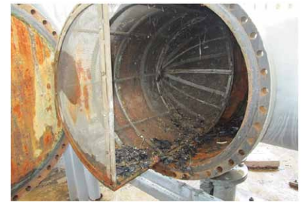
Rys. 8. Zanieczyszczenia filtra na ssaniu pompy
