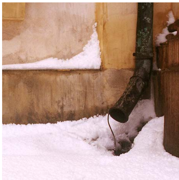
Ryc. 4. Często spotykane wadliwe rozwiązanie odprowadzenia wody z dachu
