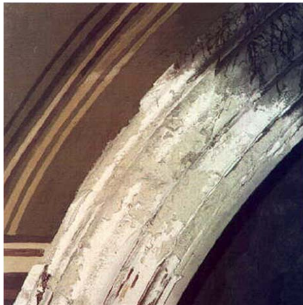
Ryc. 2. Uszkodzenia dekoracji spowodowane kondensacją pary wodnej
