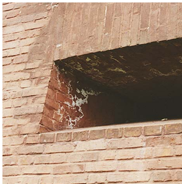
Ryc. 6. Wykwity solne na powierzchni muru ceglanego
