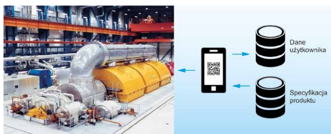
Rys. 3. Przykładowy zespół maszynowy – turbogenerator i jego otoczenie
