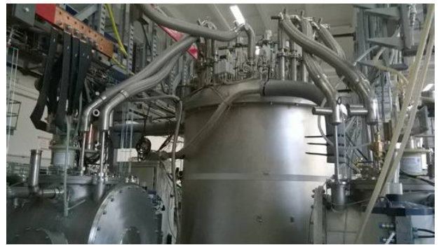
Fot. 6. Hala montażu elementów systemu NICA – wspomagająca skraplarka – element usprawniający system chłodzenia nadprzewodnikowych elektromagnesów
