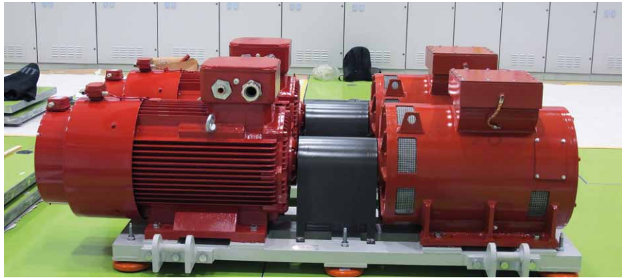
Rys. 1. Zestaw emulujący pracę rzeczywistych elektrowni, elektrociepłowni zawodowych oraz hydrozespołów odwracalnych
