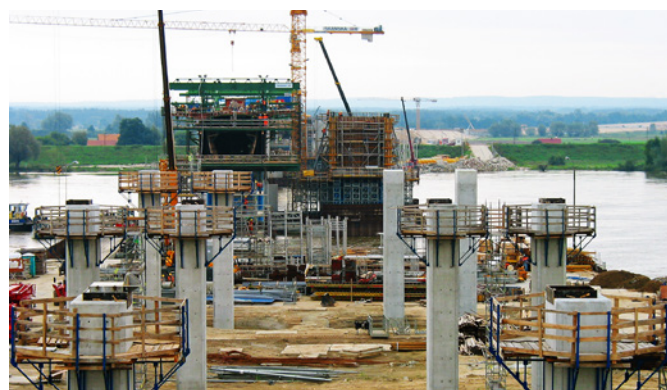
Ryc. 9. Budowa mostu przez Wisłę w ciągu autostrady A1 w Grudziądzu, fot. K. Gwizdała
