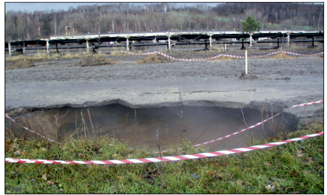
Fot. 11. Zapadlisko powstałe w wyniku pożaru chodnika Fot. 11. The cavity as result of fire in gallery
