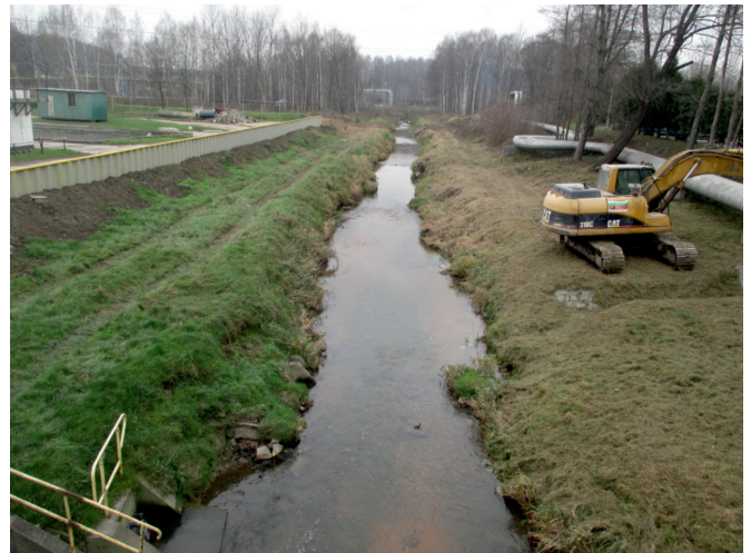
Fot. 7. Uporządkowane koryto rzeki Miedzianki oraz wykonana w 2013 r. ścianka szczelna z pali Larsena.
