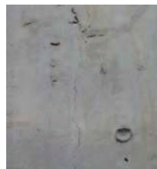
Rys. 10. Pionowe pęknięcia ściany oporowej
