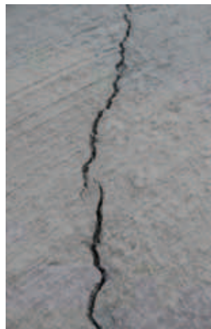
Rys. 4. Pęknięcie betonu podłoża wskutek skurczu plastycznego
