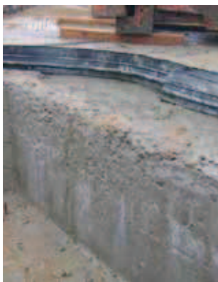
Rys. 12. Przemrożony beton ścian fundamentowych wielokondygnacyjnego budynku mieszkalnego
