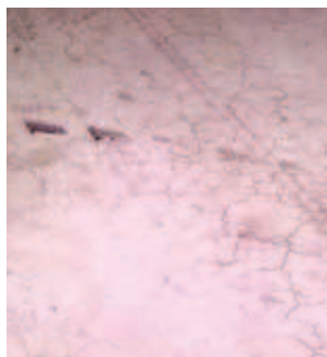
Rys. 7. Mikrozarysowania powierzchniowe posadzki przemysłowej utwardzanej powierzchniowo
