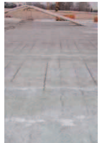
Rys. 5. Rysy nad zbrojeniem głównym płyty stropowej wskutek skurczu plastycznego betonu
