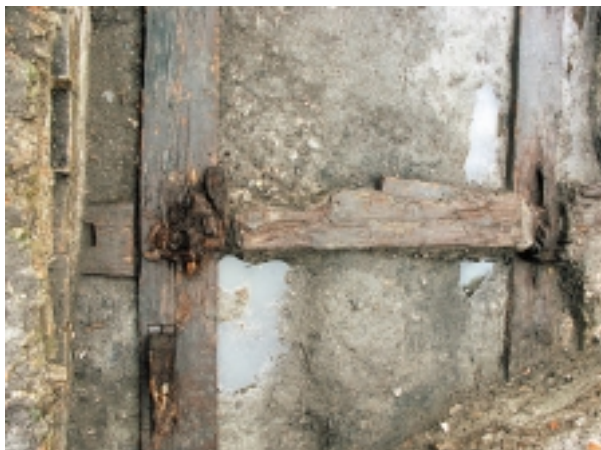
Ryc. 14. Widok z góry. Widoczny brak połączenia belki podwalinowej z położoną po lewej stronie podstawą przypory (fot. M. Gawlicki)
