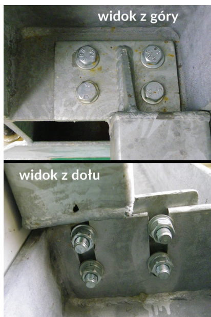
Rys. 4. Realizacja rozwiązania zamiennego połączenia ryglów ścienny – słup, stwarzająca zagrożenie katastrofą budowlaną
