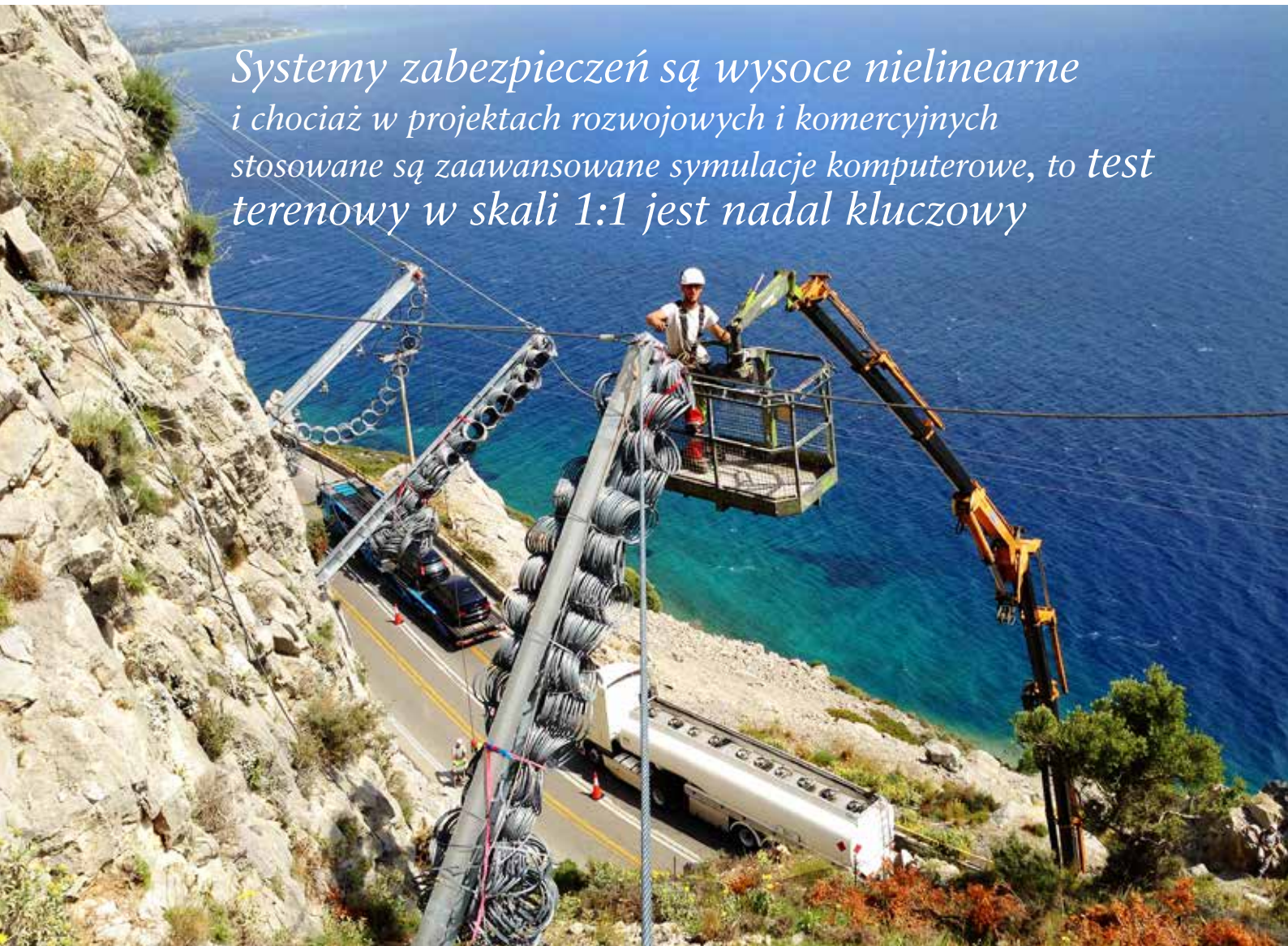
Bariera przeciwoślamiowa, system GBE, Grecja, Klokova
