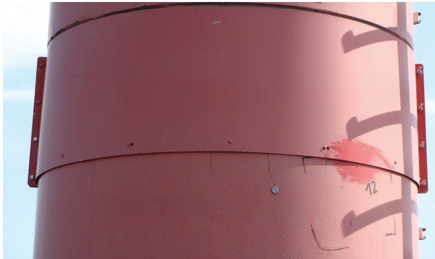
Fot. 3. Rysy pionowe i poziome w strefie złącza
