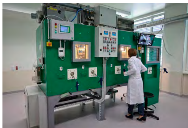
Fot. 4. Komora gorąca do pracy z otwartymi źródłami promieniowania o dużej aktywności w zmodernizowanym budynku [6] (fot. IChTJ) Photo 4. Hot chamber for working with open radiation sources with high activity in a modernized building [6] (photo: IChTJ)
