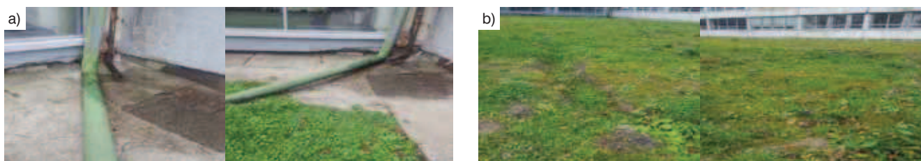
Rys. 5. Niewłaściwe odprowadzanie wody deszczowej z połaci dachu budynku nr 4: a) miejsce początkowe rur spustowych, b) obecne miejsce wylotu wody
